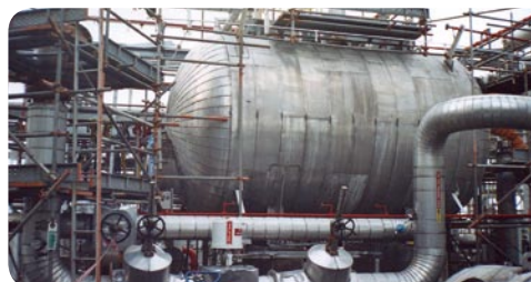
↓:エチレン蒸発器 ご提供:Optimal Chemicals 社 (マレーシア)
