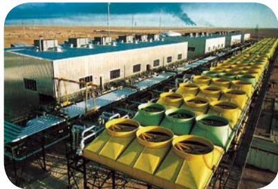
↑:圧縮機の冷却器 ご提供:Nuove Pignone 社 (アルジェリア)
