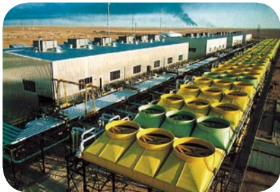
Компрессорные охладители, Алжир. Собственность: Nuovo Pignone
